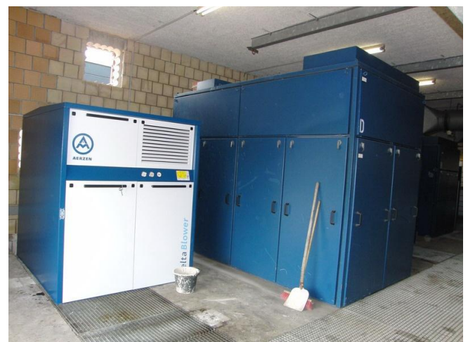
Bild 4: Komponenten der neuen Rinnenbelüftung (oben) und Gebläse für Belebung
