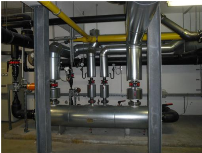
Altes BHKW-Modul (oben links) - neues BHKW-Modul (oben rechts)
